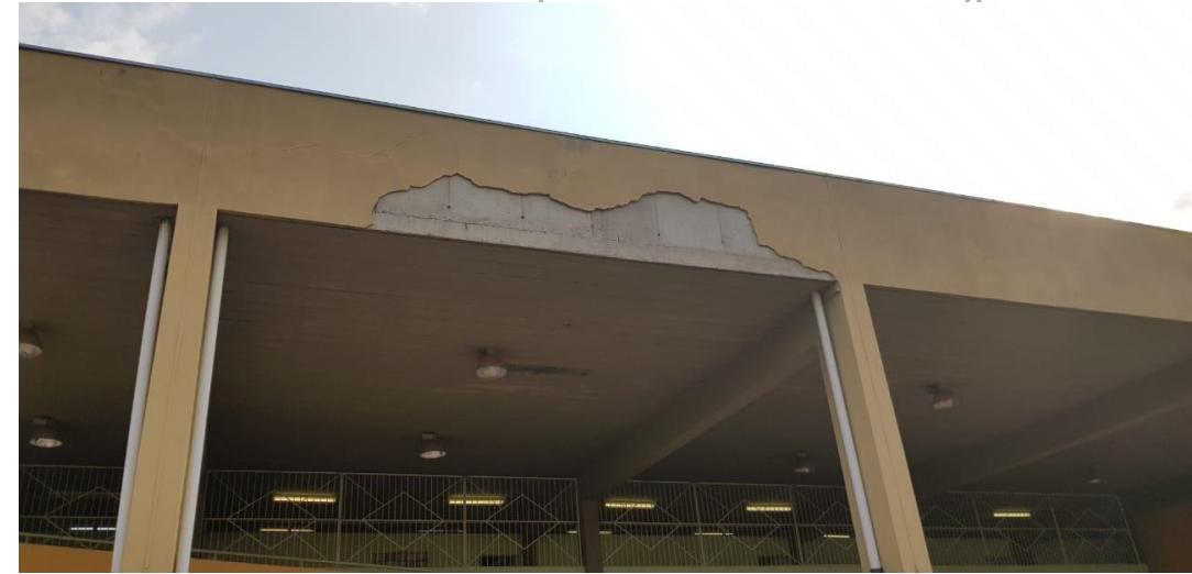
Dessolidarização de revestimento de argamassa
