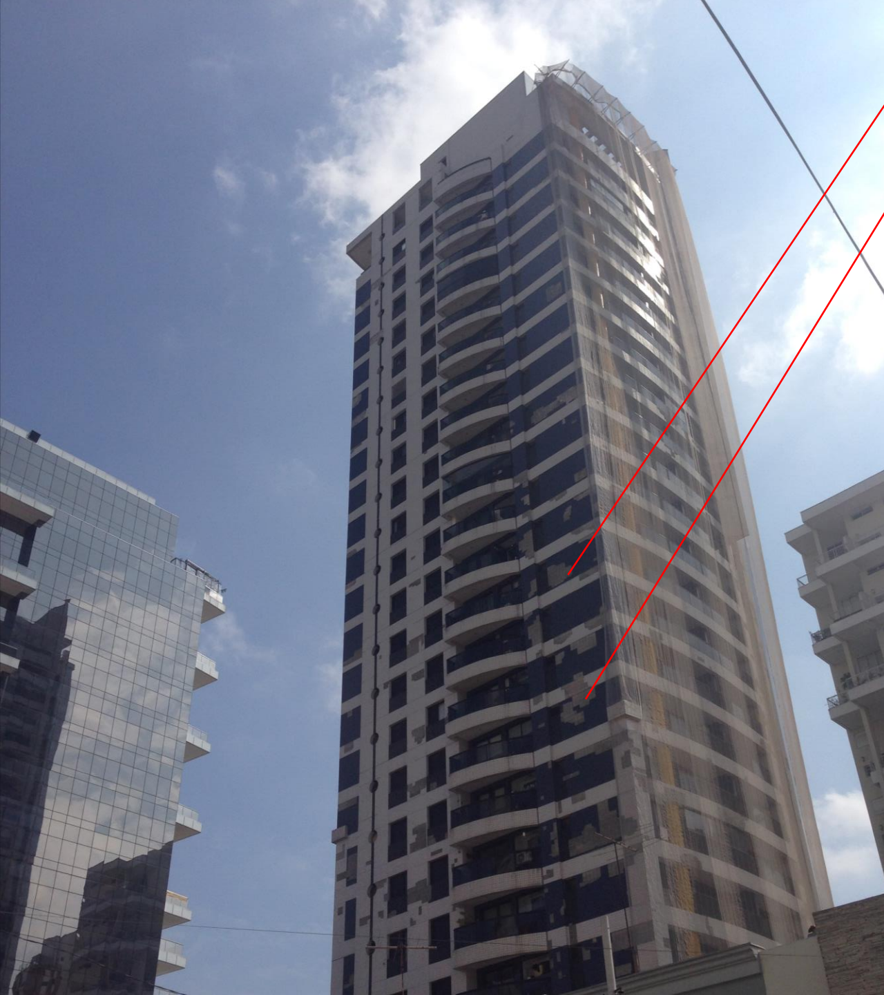
Dessolidarização de revestimento cerâmico em fachada
