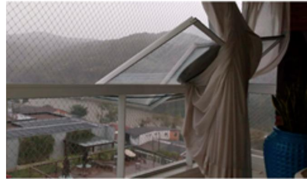
Dessolidarização de esquadrias
